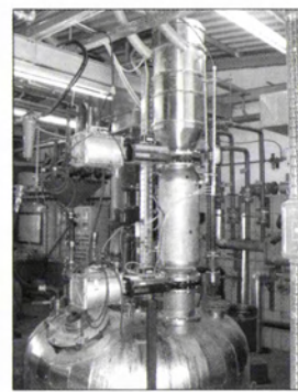
パウダーロックユニット (溶剤タンクへの投入)
